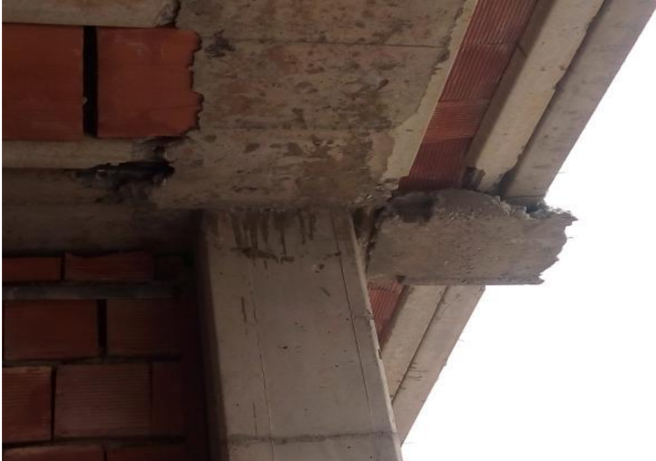
نمونه هایی از آسیب دیدگی تیرهای بتنی
